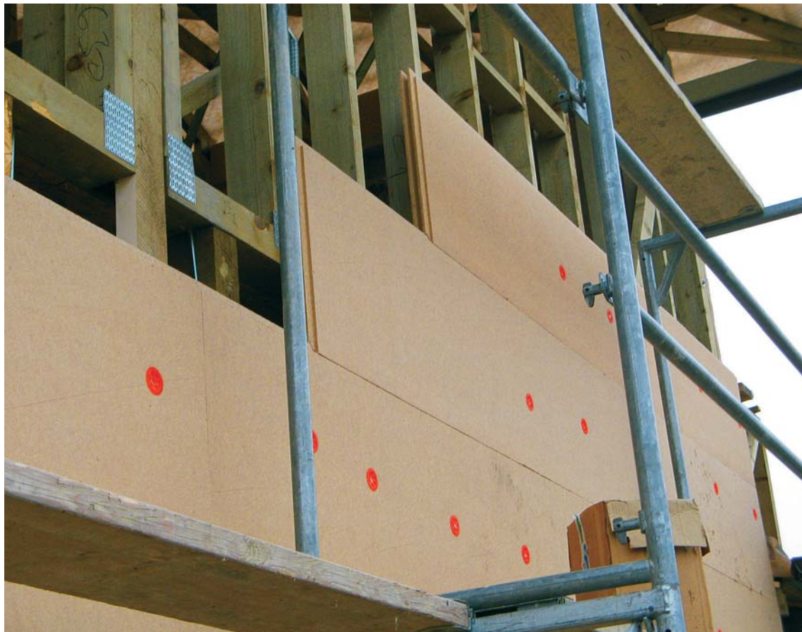
Drevená rámová konštrukcia, z vonkajšej strany doska Hofatex SysTherm určená na omietanie, z vnútornej OSB doska, izolačná výplň po uzatvorení stien bude fúkaná celulóza, Hofatex Smrečina
